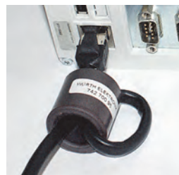
Abbildung 7: Beispiel zur Abschirmung Ethernet-Leitung: Schlaufe 2-fach durch Ferrit
