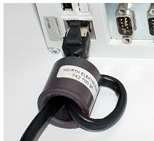
Abb. 34 Ethernetkabel, Schlaufe 2-fach durch Ferrit
