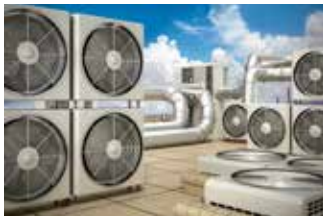
Heizung-, Klima-, Lüftungstechnik
